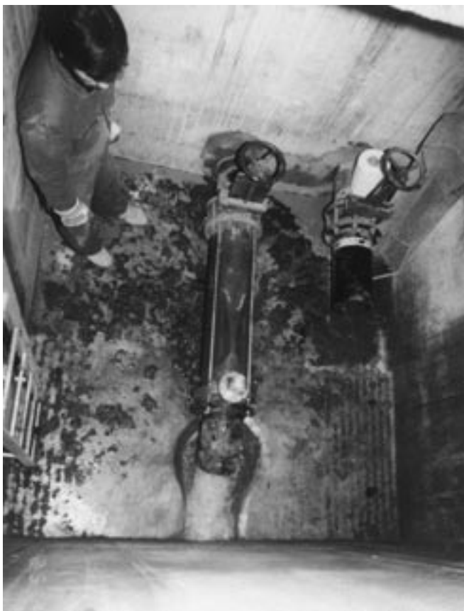
Fig. 5 : Régulateur à membrane UFT- Fluidhose type U, DN 200 en implantation sèche. A droite, le bypass.
