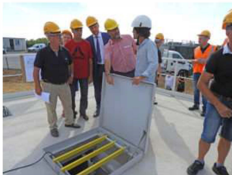
Trois suppresseurs d'air ont été installés dans le poste de refoulement pour envoyer les eaux usées de la commune dans le nouveau réseau collectif.
